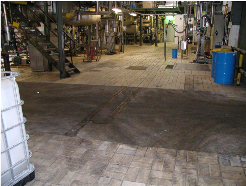
Bild 1: Bodenflächen vor der Sanierung
